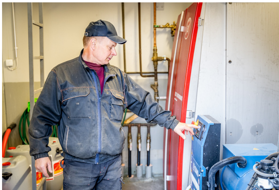
Vid strömavbrott finns det en generator som producerar ström, säger Henrik Gammelgård
