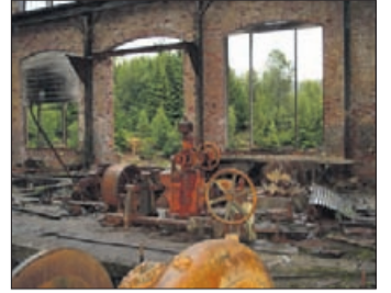
Både byggnader och maskiner vittrar långsamt sönder.
